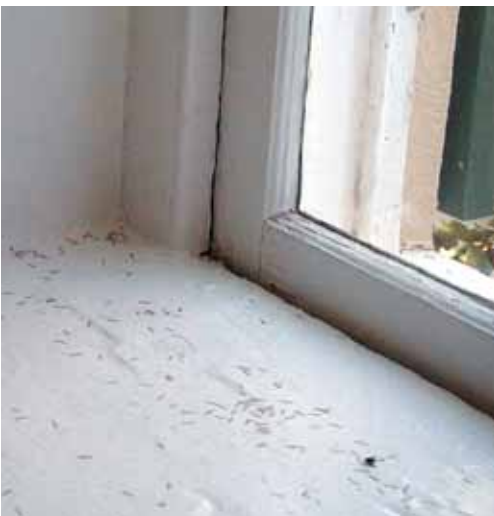
Fig. 8. Alas en un marco de ventana son señales de infestación. (B. T. Forschler)
